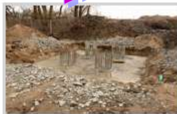
Podkladní beton s výtěží pilot základu pro opěrnou lávku na čelákovické straně. Foto: archiv ORM
